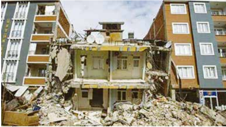
図3 地震の被害写真(AFAD資料より)。倒壊した脆弱なビルの両脇には、倒壊を免れたビルがみられる。
